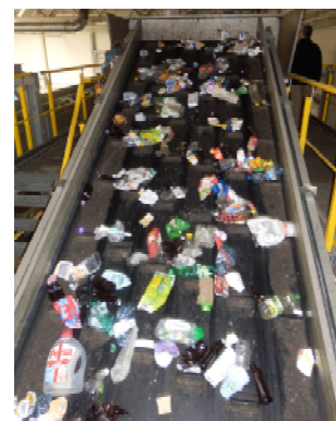
Transportband der modernen Erfassungs- und Sortieranlage für gemischte Kunststoffabfälle aus Haushalten
